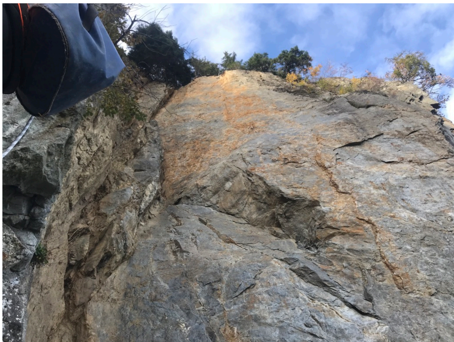
inspection de la cicatrice de départ en falaise (vue en contre-plongée)
